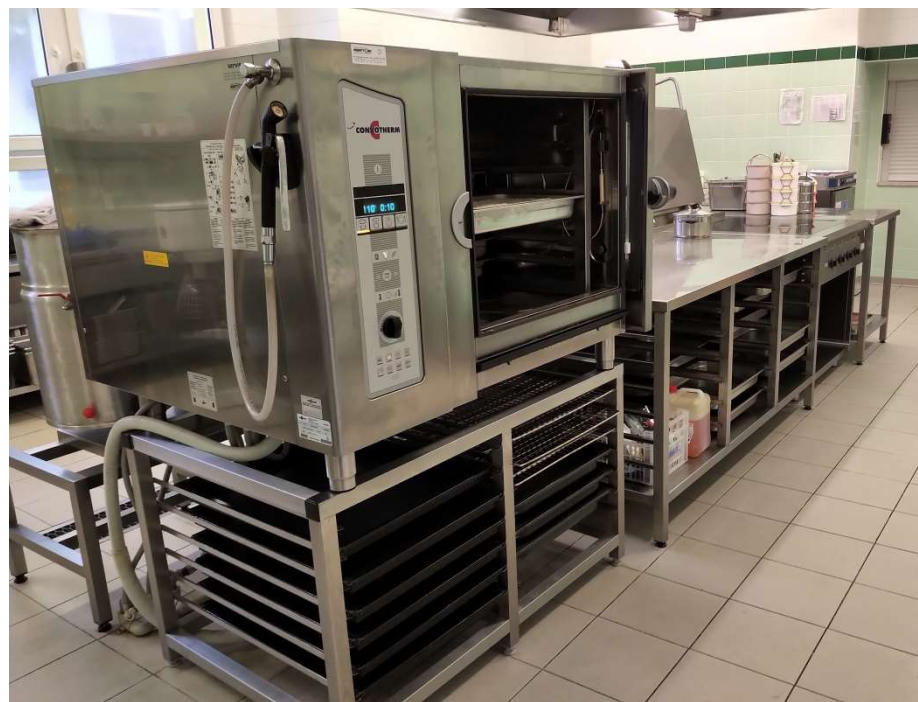
REFERENCE / Školní jídelna Čeladná – výdej 300 obědů denně
